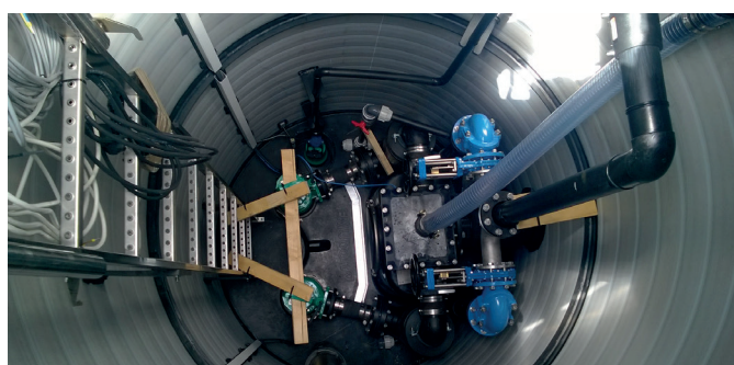
NOWA TŁOCZNIA ŚCIEKÓW W SIEDLESZCZANACH
