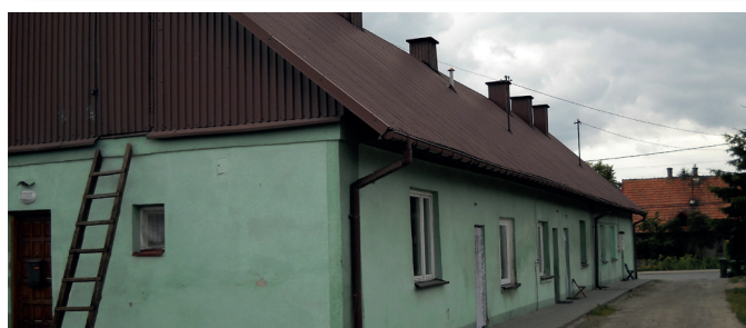
ZANIEDBANE „CZWORAKI” PRZED MODERNIZACJĄ
