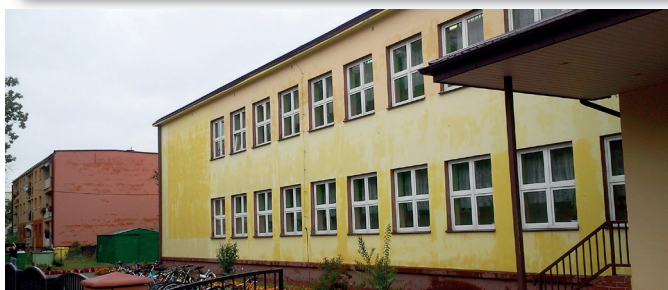
SZKOŁA W SKOPANIU PRZED REMONTEM
